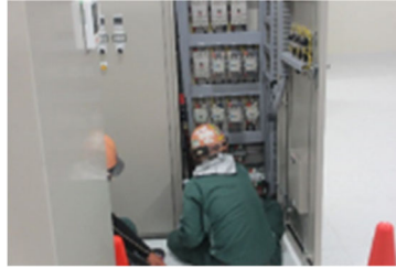
配電盤接地抵抗測定
