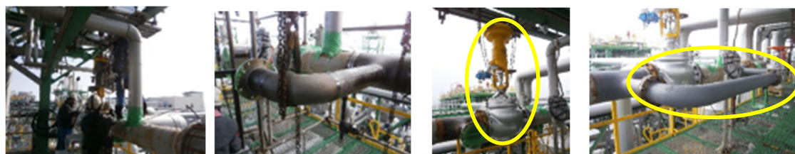
既設弁取り外し 配管切込み ①新規アンチサージ弁 ②手動バイパス弁設置
