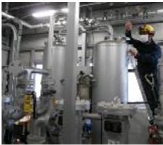
計装空気ドライヤー点検
