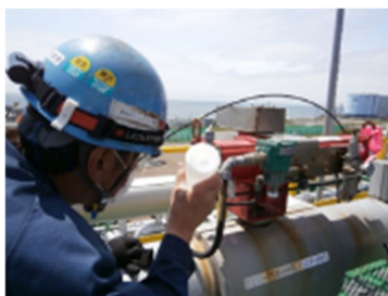
計装空気配管漏洩確認
