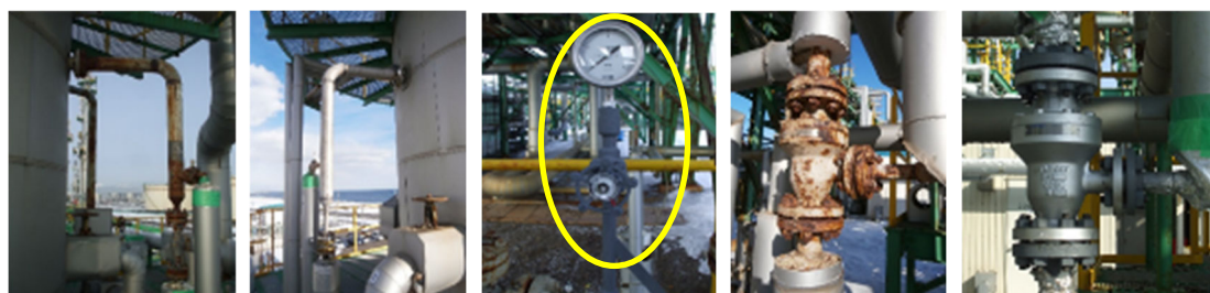
脱気器入口配管材質変更 圧力計設置 更新前自動再循環弁 更新後
