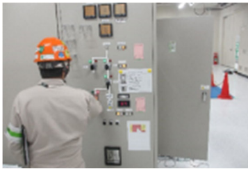
高压配電盤点検
