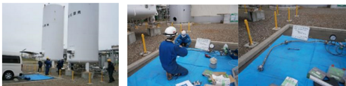
窒素製造設備検査
