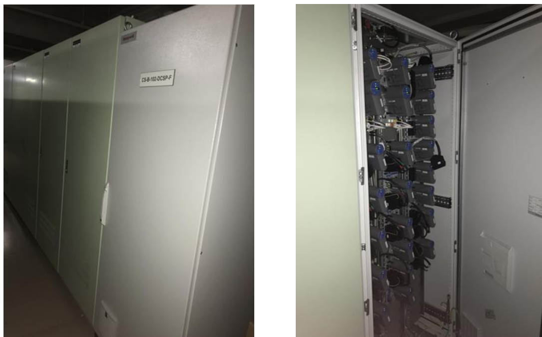
図 1.2-1 設置した更新 DCS 装置の外観および内部の様子
