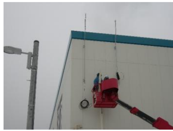
GPSアンテナ、ケーブル
