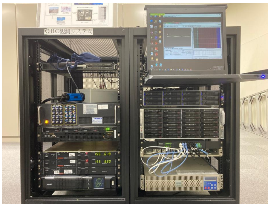
図 4.2-6 データ収録部 (測定器 GeoRes システムのレコーダ部分)
