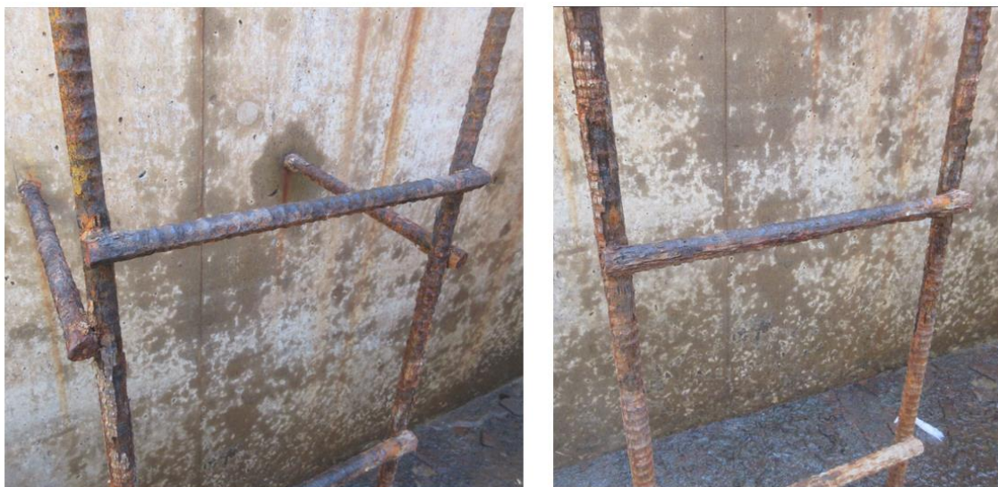
図 4.8-8 観測井 OB-2 セラー内梯子腐食状況
