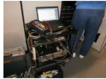
制御機器点検
