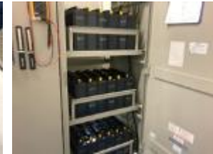
バッテリー設置状況
