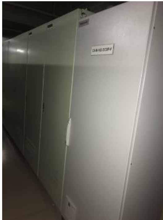
図 2.1-2 現場に設置された更新 DCS 装置外観
