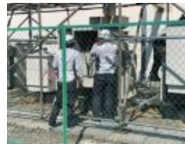
屋外電気設備点検
