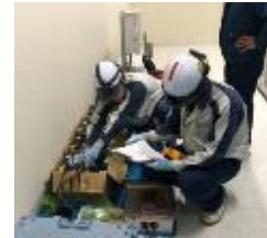
バッテリー交換
