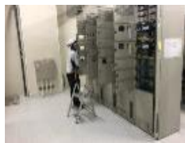
モーターコントロールセンター点検
