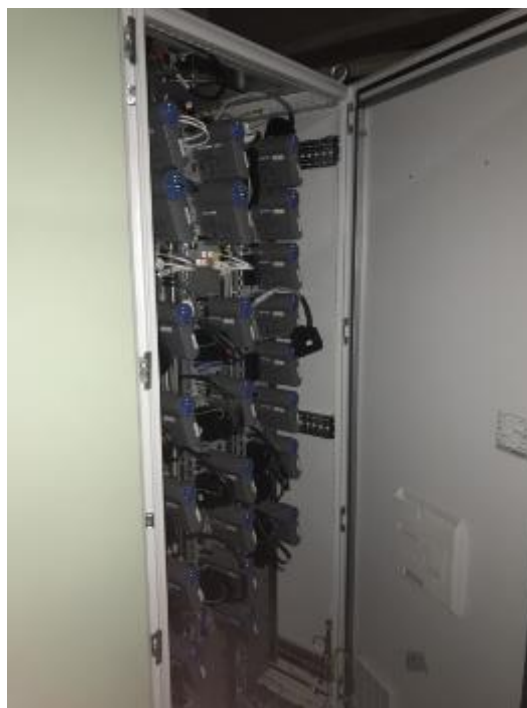
図 2.1-3 現場に設置された更新 DCS 装置内部の様子
